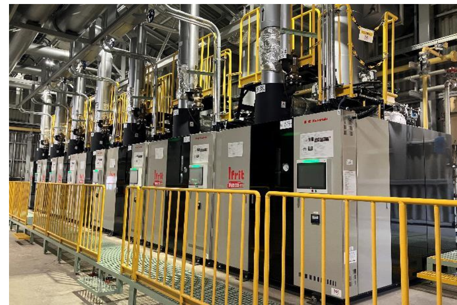
LNG Boiler Facilities (Nickel Refinery)
