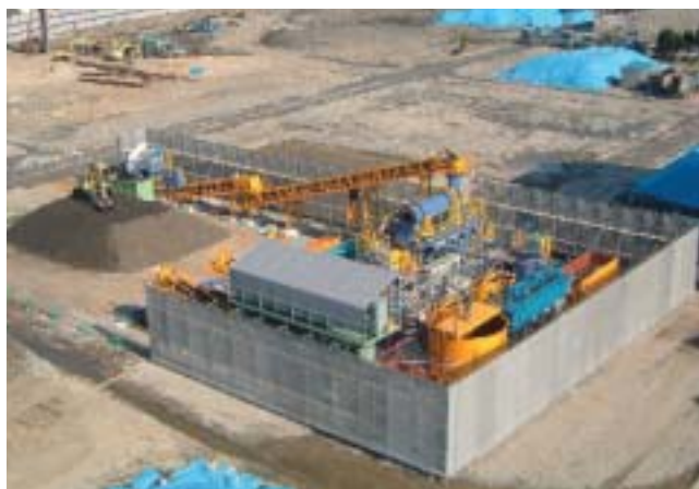
油脂汚染土壌洗浄装置
