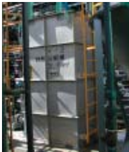
お客様の事業所に設置されたN-Free設備
