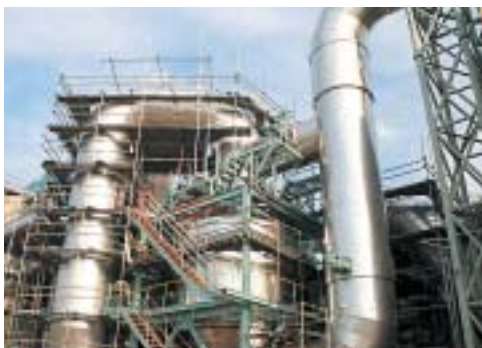
転化器ボイラー(愛媛県 東予工場)
