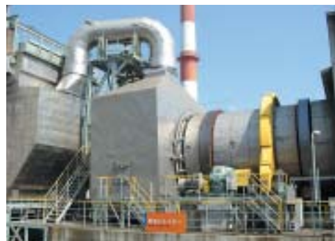
ロータリースチームドライヤー(愛媛県 東予工場)
