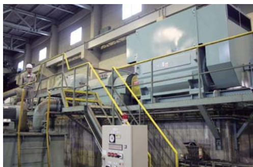
東予工場 転炉ブローター
