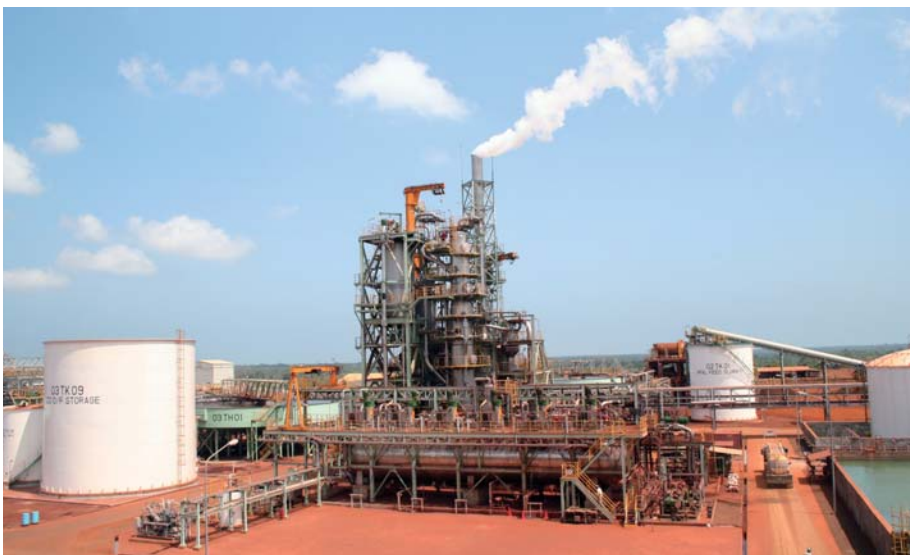
フィリピン コーラルベイニッケル社のオートクレーブ(高圧釜)設備 鉱石を硫酸で溶かして高温に熱し、高圧をかけてニッケルとコバルト分だけを取り出す
