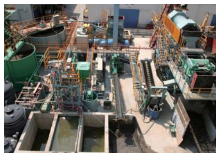
重金属汚染土壌浄化プラント
