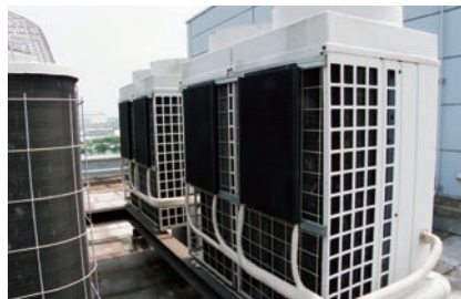
室外機と、室外機に追加されたテルコン
