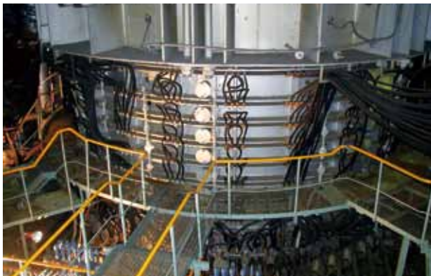
東予工場自熔炉の外観
