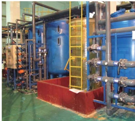
▲排水処理システムの緊急用のバルブと貯水槽
