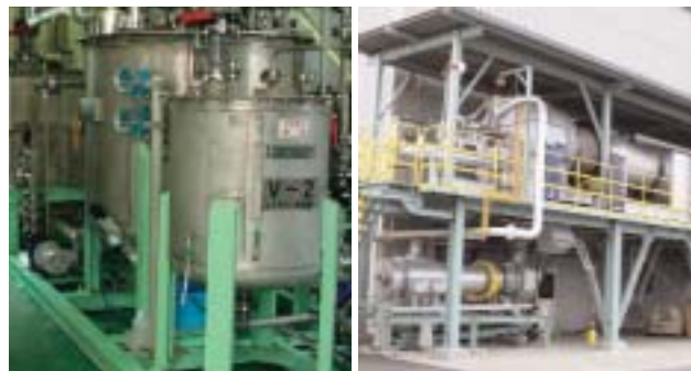
左)高濃度硝酸性窒素処理設備(N-Free) 右)SFAT設備
