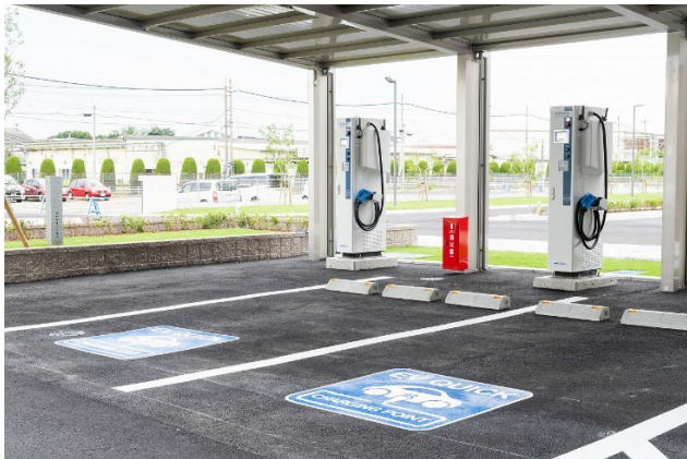
【EV 充電スタンド】
