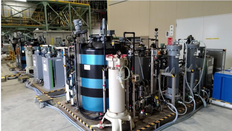
実証試験用のパイロットプラント
